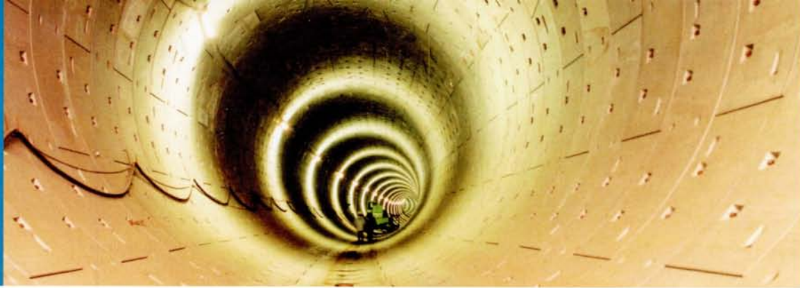
De 1,2 km lange tunnelkokers hebben een binnendiameter van 7,3 m en bevinden zich 18 m onder de grond.
